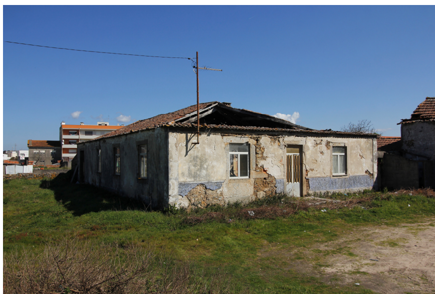
Figura 10 – Edifício em ruína
